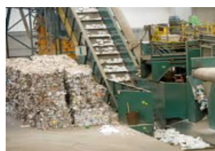
Compresseur de déchets solides
